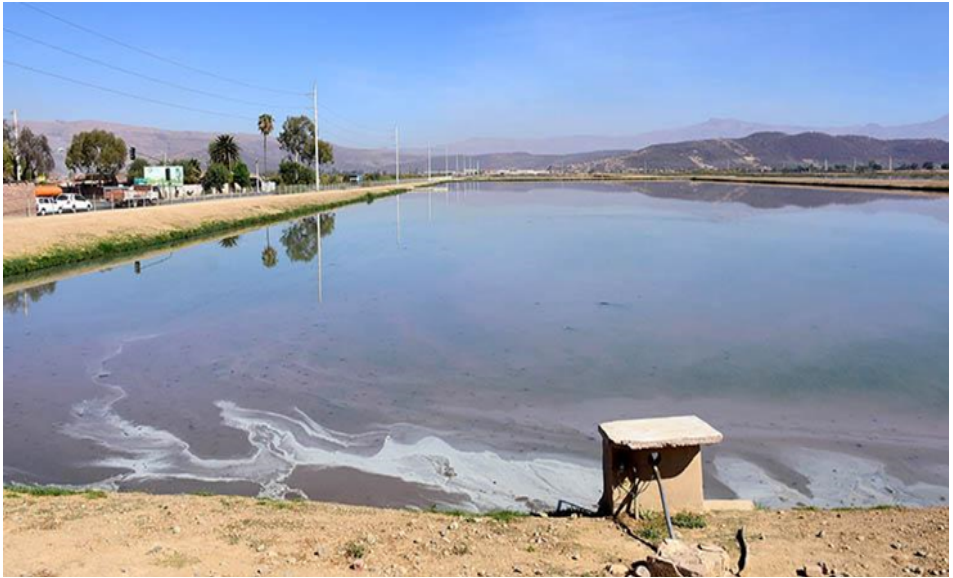
Figura 3 Lagunas de Oxidación de la Antigua y Colapsada PTAR de Albarrancho
